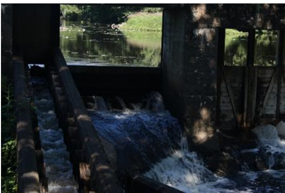
Figur 4 Exempel på denilränna (uppströmspassage) som rinner ut i naturfåra. Bilden är tagen vid Torsrum vattenkraftstation.
